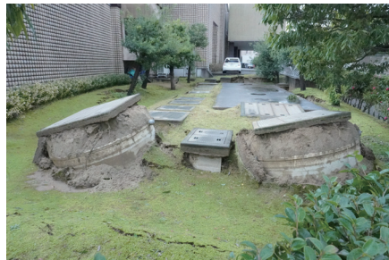
被災画像（浄化槽）
